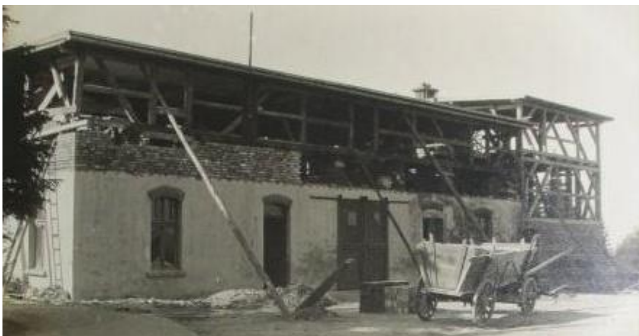
▲ Misijní dům „Felsenhôtel“ na Bukovině na dobové pohlednici a snímku z výstavby.
